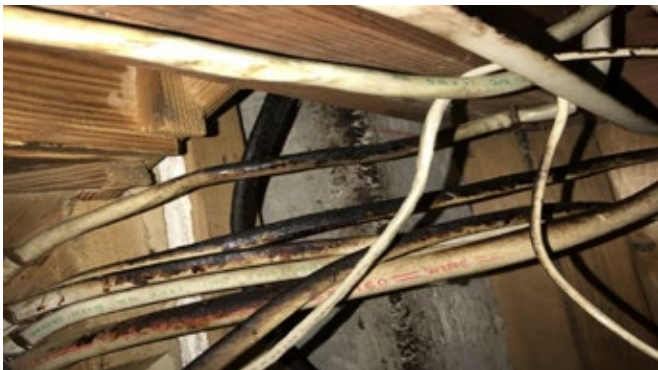
▲ Cables ennegrecidos, recubiertos de grasa y mugre acumuladas.
