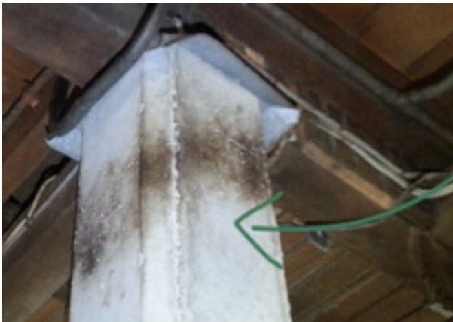
▲ Evidencias físicas: Senderos, rastros de grasa en vigas y mamposterías.
