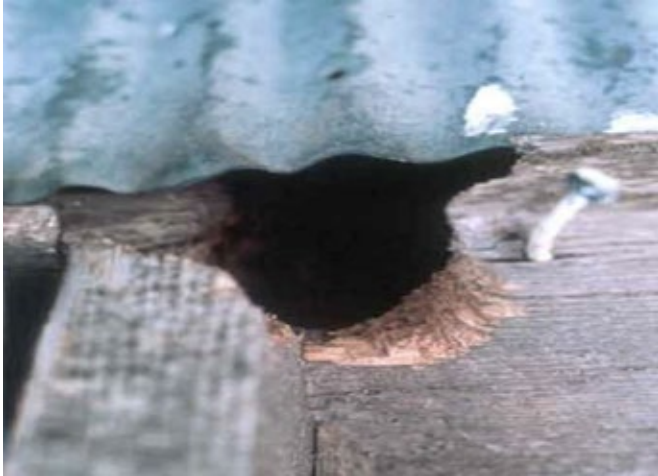
▲ Evidencias físicas de infestación: Postes de madera roídos.
